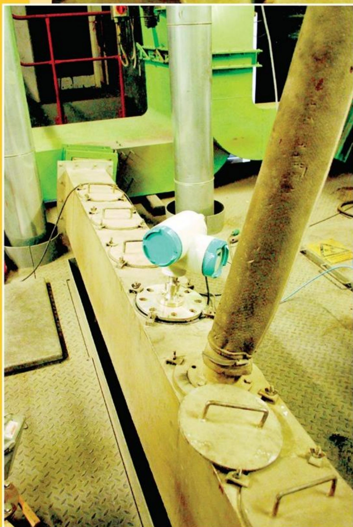
På forbrændingsloftet over forbrændingsristen sidder en LR460 radar og måler niveauet af affald på forbrændingsristen.
