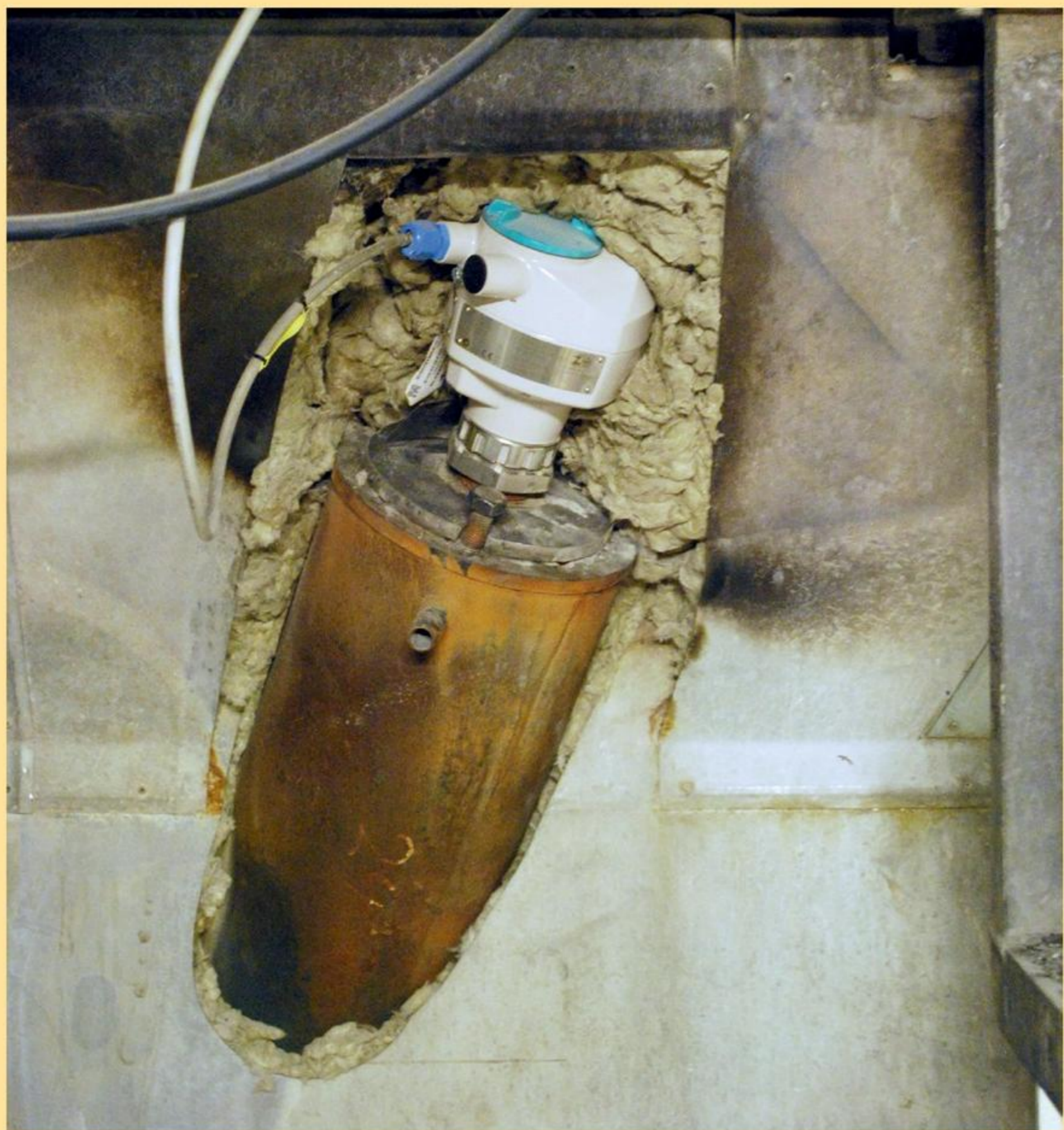
I slaggefaldet sidder en Sitrans LR250 radar, der måler niveauet i slaggefaldet og giver alarm, hvis der er tegn på blokering.
